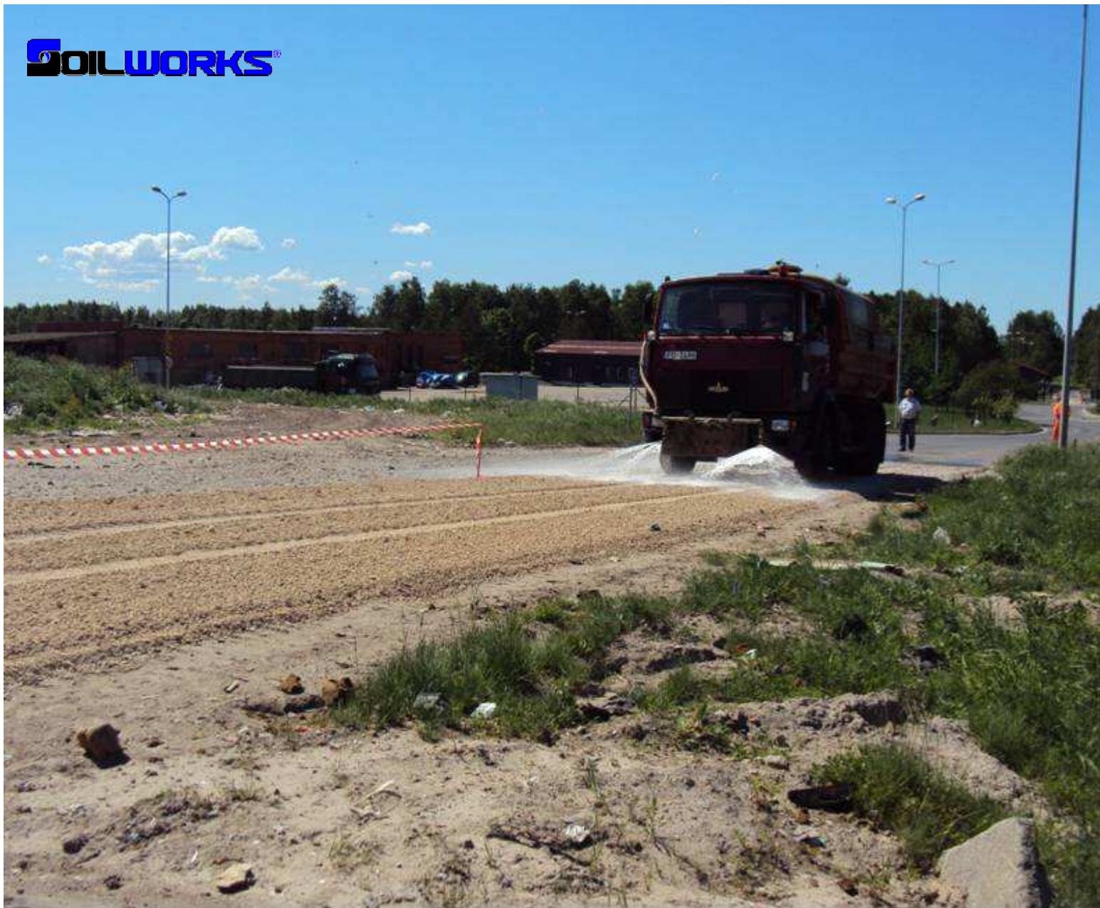
Начало полива раствором Соилтак. Расход соилтака табличный, добавление воды по замеру: до достижения оптимальной влажности существующей фактической влажности грунта в момент внесения раствора.
